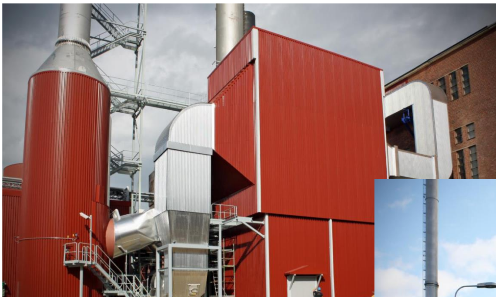
Электрофильтр на ТЭС г. Ванайа в Финляндии
