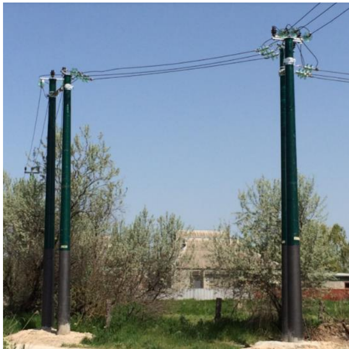
Композитные опоры ВЛ 6–10 кВ ПАО «Кубаньэнерго»
