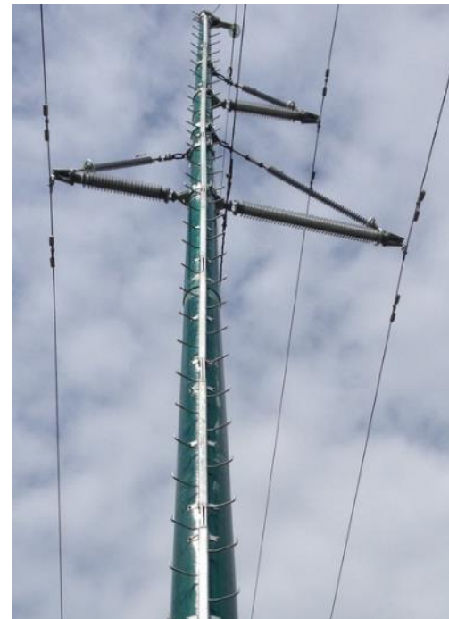
Композитные опоры ВЛ 110 кВ ОАО «Янтарьэнерго»
